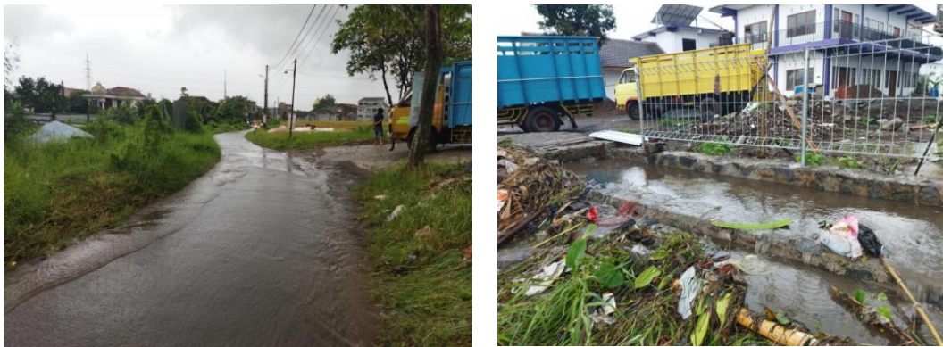
Gambar 2. Kondisi drainase existing tidak bisa menampung limpasan air hujan
