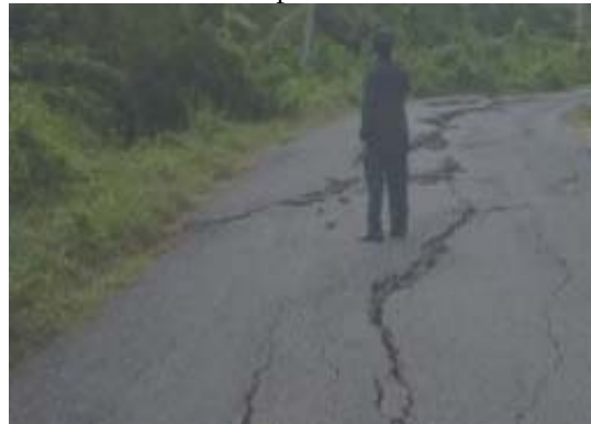
Gambar 1. Kondisi kerusakan badan jalan
